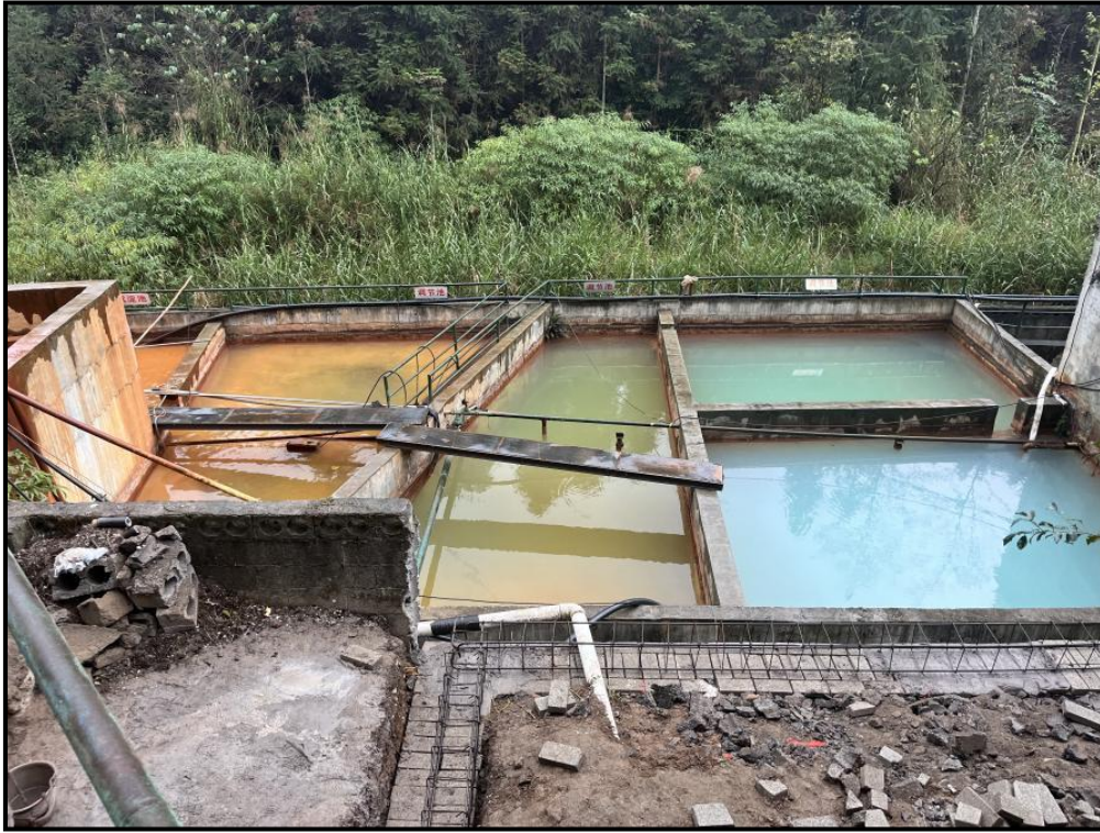
图 4.2-3 兴仁四联乡八公桩二湾联营煤矿污水处理站
